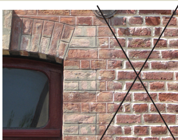
A gauche, rejointoiment correct, tiré au fer; à droite, joint trop large et trop clair.
