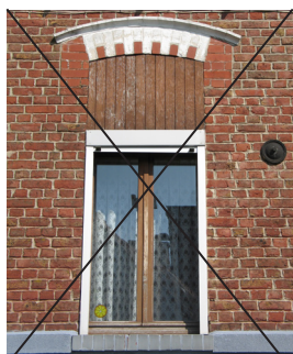
Baie réduite, à restituer dans ses dimensions d'origine.
