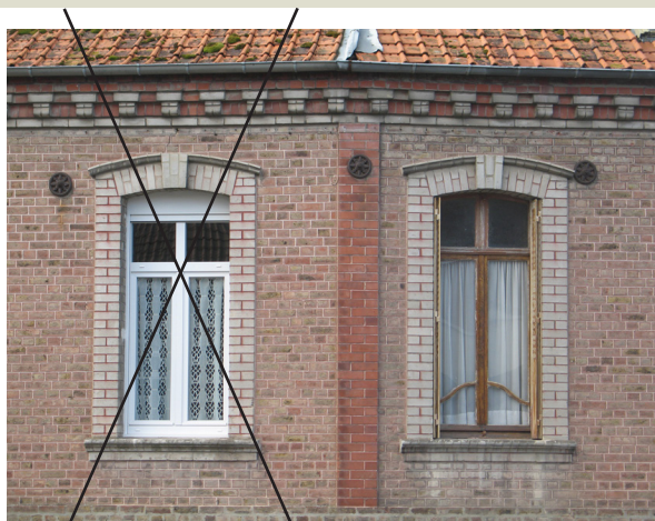
Perte de dessin et réduction de surface vitrée avec le changement de menuiserie
