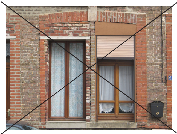
Modifications inadéquates de baies, en fonction de menuiseries standards.
