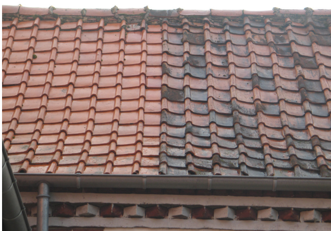
A droite, pannes du Nord anciennes, droitières, de diverses teintes, remplacées à gauche, par des pannes industrielles de teinte uniforme. En faitage, des tuiles demi-rondes, à recouvrement.
