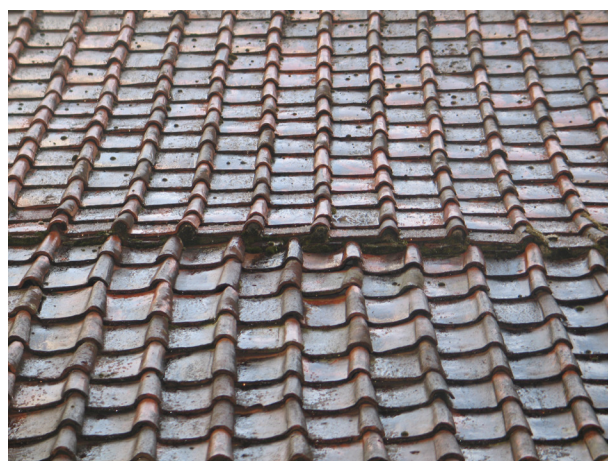
En bas, pannes du Nord anciennes, gauchères, remplacées en haut, par des pannes industrielles, acceptables.
