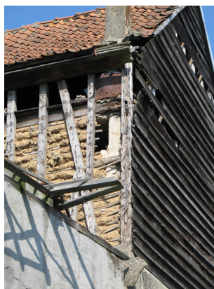
Pan de bois, gouttereau rempli et enduit au torchis, pignon revêtu de bardage bois...à restaurer.
